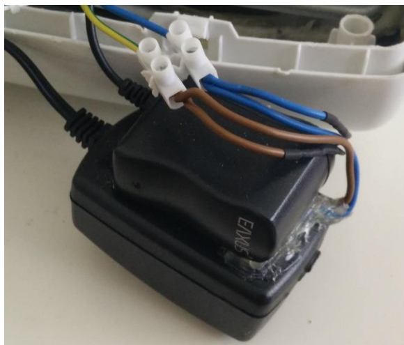
Εικόνα 52: Οι μετατροπείς εναλλασσόμενου ρεύματος
