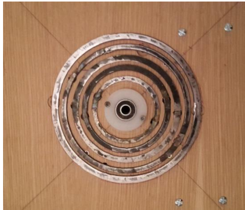
Εικόνα 95: Επάνω μέρος κεντρικής βάσης το οποίο φέρει πέντε μεταλλικούς κύκλους για τη μεταφορά ρεύματος. Κάθε μεταλλικός κύκλος αντιστοιχεί σε ένα καλώδιο στο οποίο πρέπει να μεταφερθεί ρεύμα ή ακόμη και εντολή (για την κατεύθυνση του servo y).
