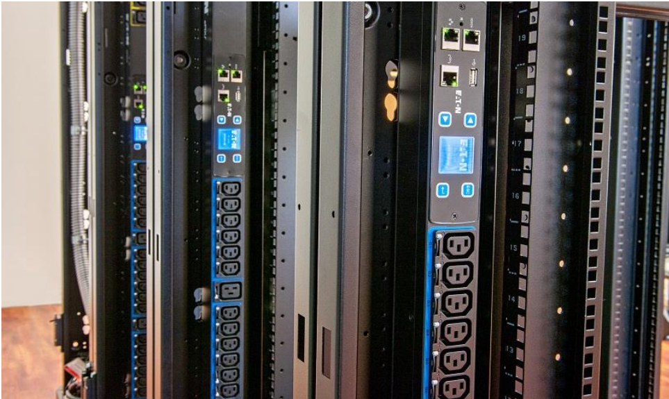
Εικόνα με PDUs τοποθετημένα πάνω στο rack του server
