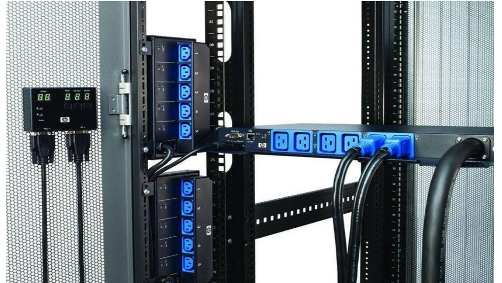
Εικόνα με PDUs τοποθετημένα πάνω στο rack του server
